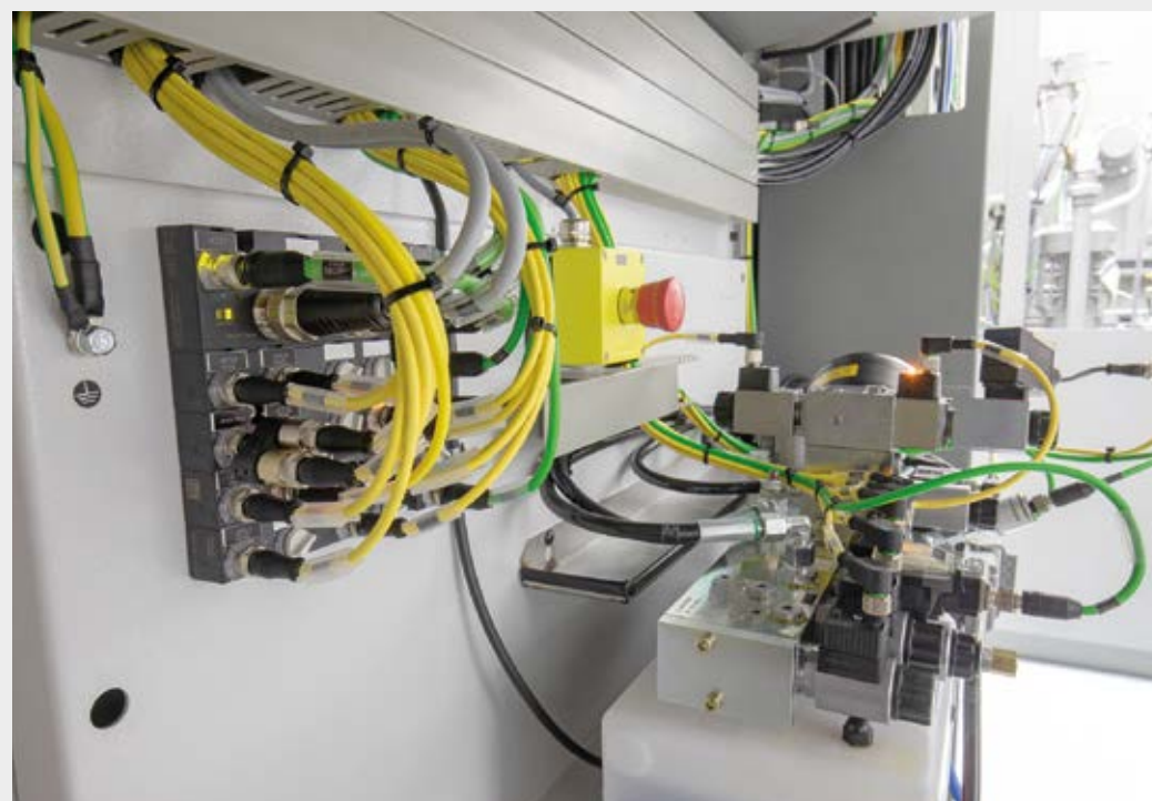
Kompaktowe moduły Cube67 zainstalowane obok procesu.
